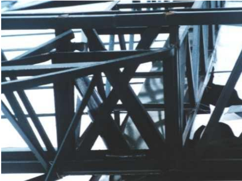
FIGURA 3. Cercha viga central colapsada .
