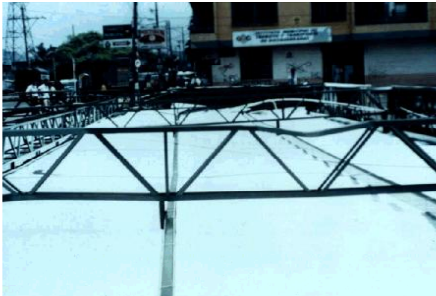
FIGURA 2. Aspecto Estructura Colapsada (Cerchas principales y los perlines, aparente falla por compresión)
