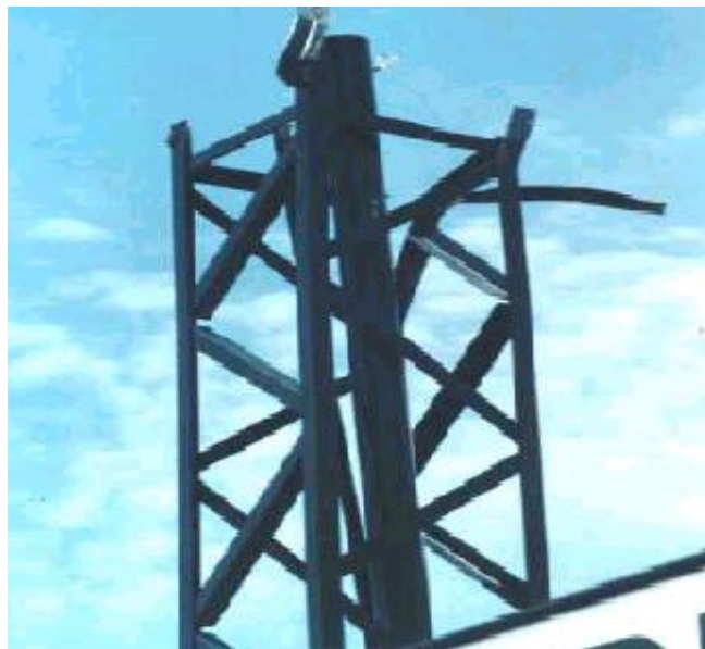
FIGURA 5 Fallas por soldadura
