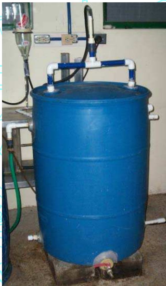
Figura No. 2. Montaje del Filtro Anaerobio de Flujo Ascendente Evaluado
