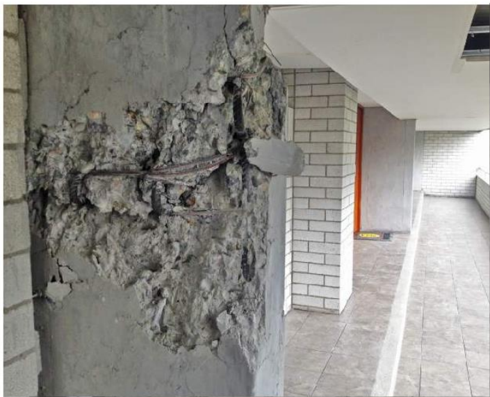
Falla de una de las columnas principales en el Sapace Sismologia en el Meta
